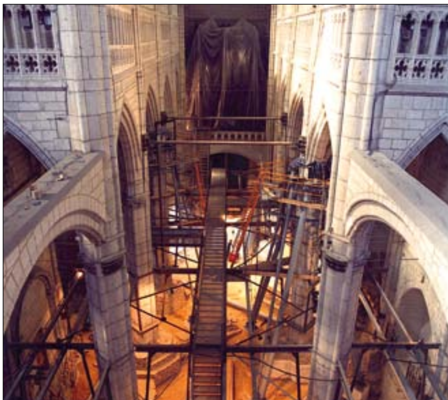
Figura 2.14. Imagen de las obras de rehabilitación en la catedral de Santa María.
